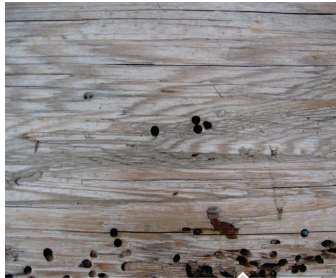
Madera afectada por xilófagos
