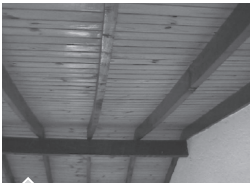
Fig. 1 – Deflexión en vigas de pino
