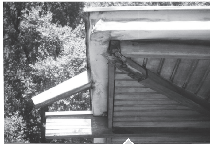
Fig. 10 Alero deteriorado por pérdidas del canalón
