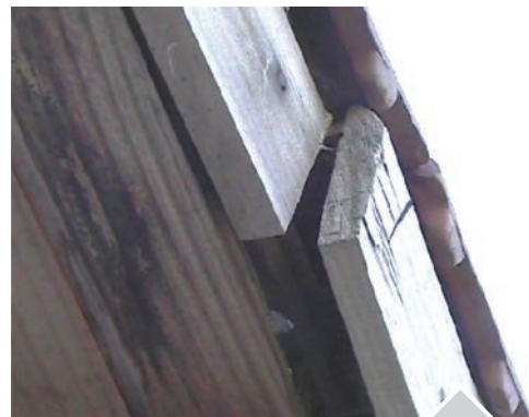
Fig.7. Cubretirante desclavado. Facilita el ingreso de agua a la estructura de madera
